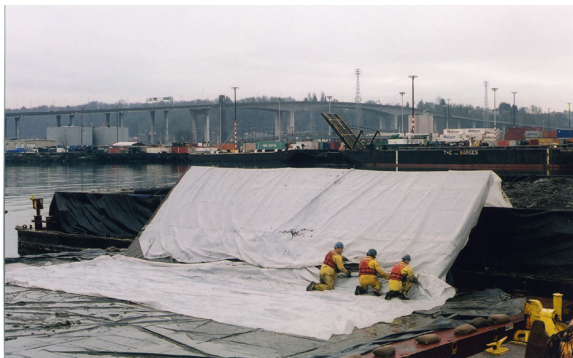
Use of spill apron
