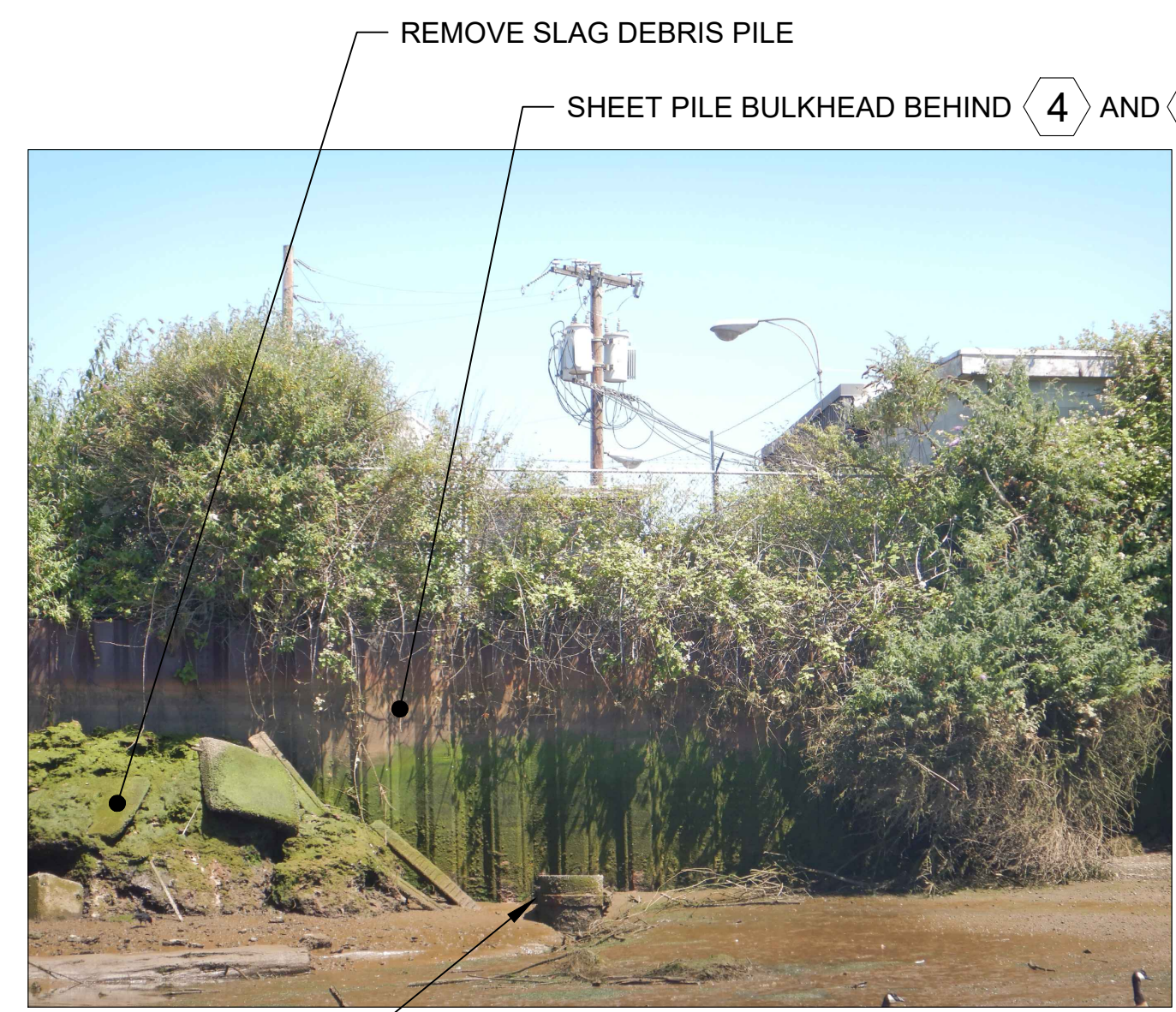
OUTFALL 2075 32" DIA STEEL RISER (3) PHOTO SCALE: NONE (1)
